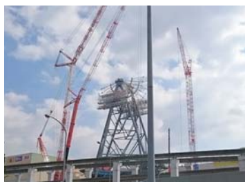
大観覧車の建設過程が見れる！と、話題になっていました。この写真は今年の3月頃のもの。
